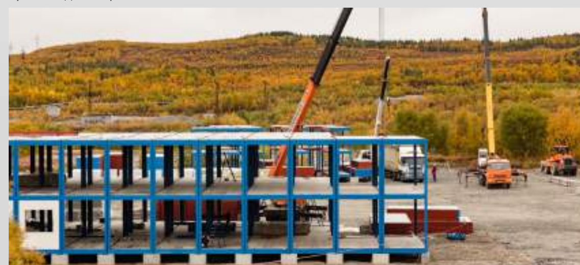
РЕСПУБЛИКА САХА (ЯКУТИЯ). ЮЖНО-ЯКУТСКАЯ ТЭС
